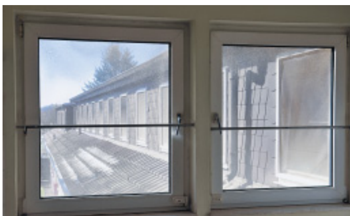
Gesichert: Gitter gibt es vor den Fenstern nicht mehr. Eine einfache Metallstange aber soll ein komplettes Öffnen der Fenster verhindern.
